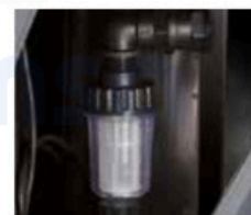
Puerta para inspección y limpieza del filtro de agua
